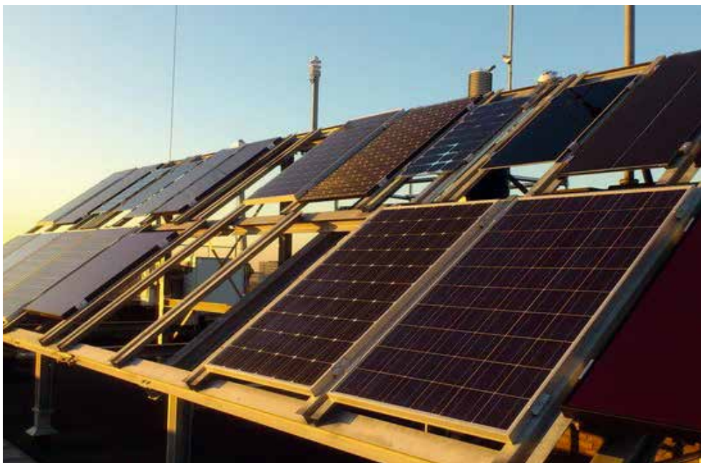
Zonnepanelen testfaciliteit bij de Universiteit Utrecht.
